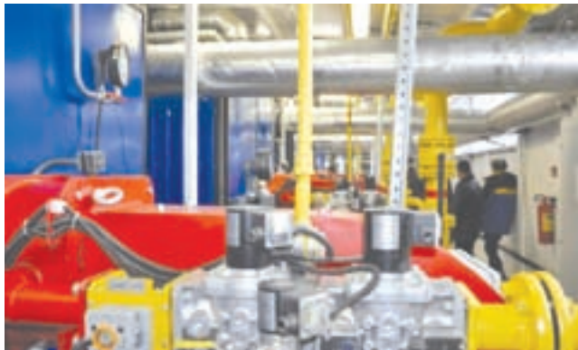
Новая котельная на Ногинке позволит улучшить теплоснабжение всего микрорайона, позволит ликвидировать водную паузу летом, а также не зависеть от покупного тепла котельной завода РАТЕП.
